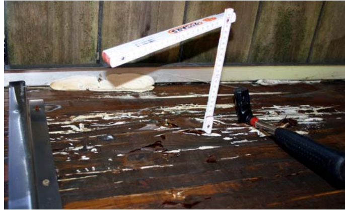
Abbildung 11. Vermoderte Stelle am Hauptträger einer Brücke bei Ellwangen-Neunheim.
