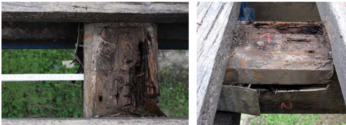
Abbildung 5. Geschädigter Nebenträger NII nach der zerstörenden Überprüfung der Messergebnisse.
