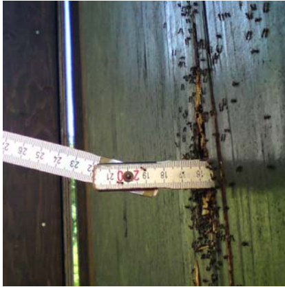
Abbildung 10. Fehlstelle an der Stütze einer Brücke bei Stuttgart-Weilimdorf nach der zerstörenden Untersuchung.
